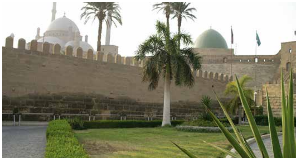
Ein Beispiel für aufsteigende Feuchtigkeit
