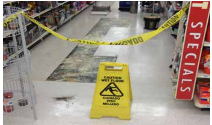
...und verursacht Ausfallzeiten sowie hohe Reparaturkosten
